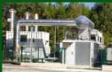
Recupero energetico da gas di discarica
