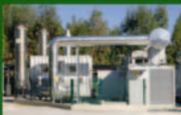
Recupero energetico da gas di discarica
